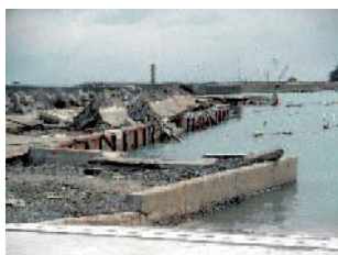
■津波で破壊された港の様子
