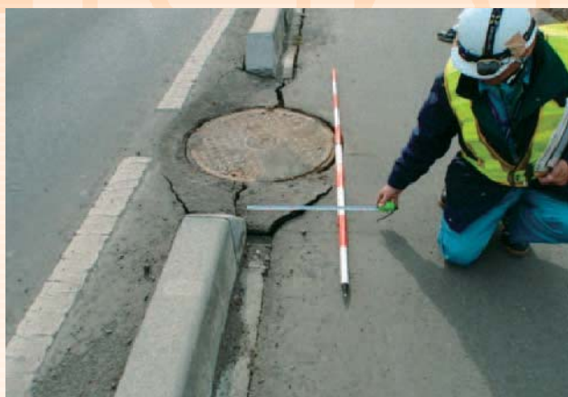
■損傷した道路の被害状況調査
