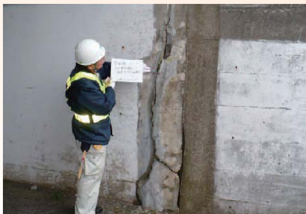
■沈下によりヒビが入った擁壁の調査
