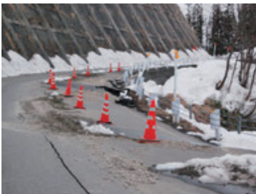
■路肩が崩壊した村道（H23.3.15）→復興状況（H24.9.18）
