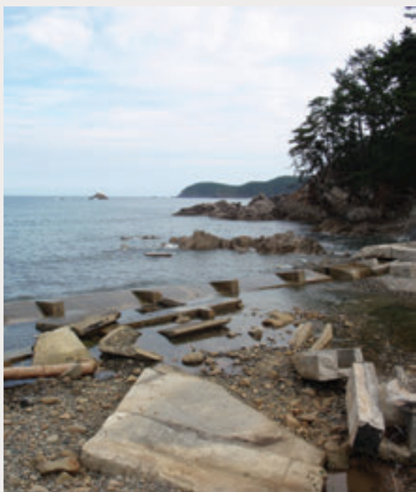
■ 震災で被害を受けた防潮堤、社会資本整備の重要性を再認識した（山本氏提供）
