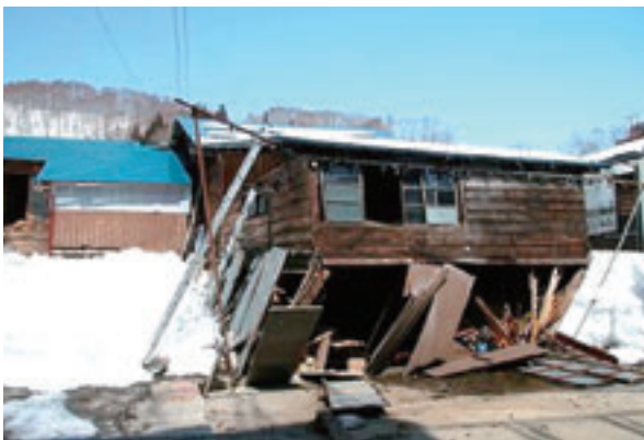
■森集落被災状況
