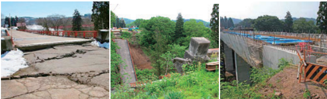
■中条川にかかる中条橋（青倉地区）→ H24.1.29積雪347cmによる崩落→ H25.8.9の様子
