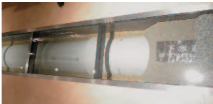
■館内を走る本物の下水道管
