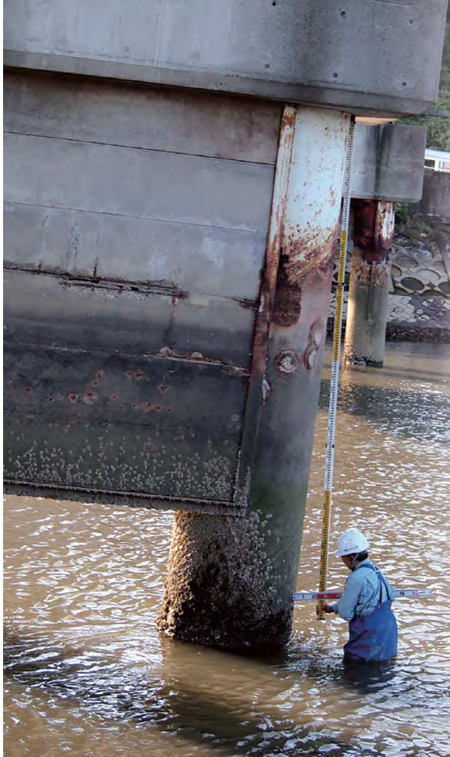
■河川部の橋梁損傷計測
