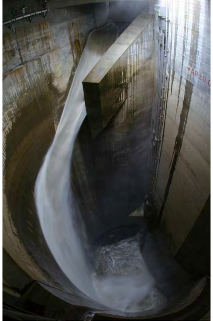
■第3立坑の渦流式ドロップシャフト
