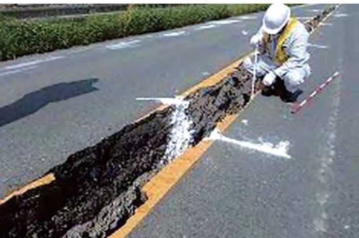
■堤防天端の縦断亀裂
