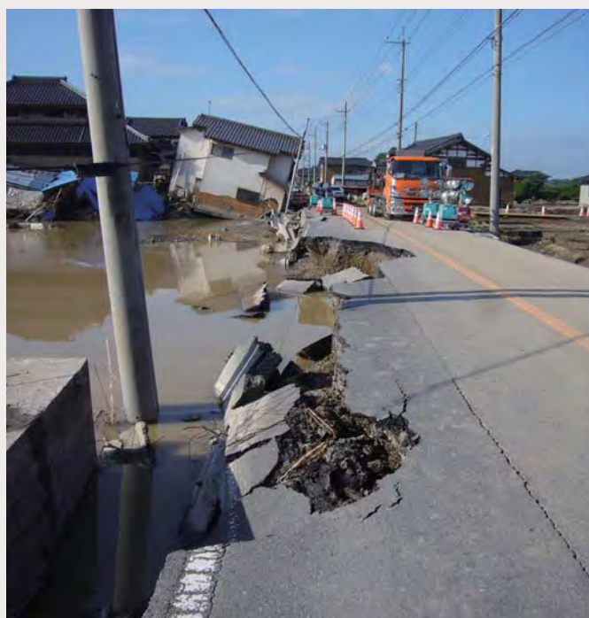
■平成 27 年 9 月関東・東北豪雨では、鬼怒川が決壊し、常総市では大きな被害が発生（三井氏提供）
