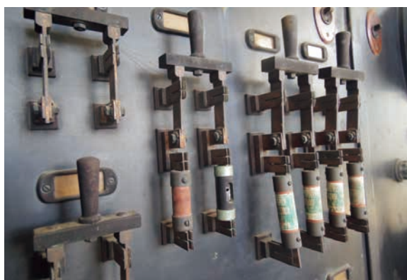
■運転室に置いてある配電盤
