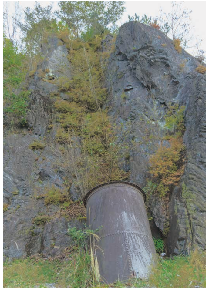
■発電所の水圧鉄管の一部
