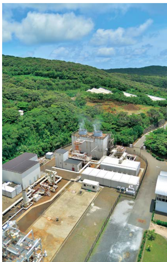
■写真2 八丈島地熱発電所
