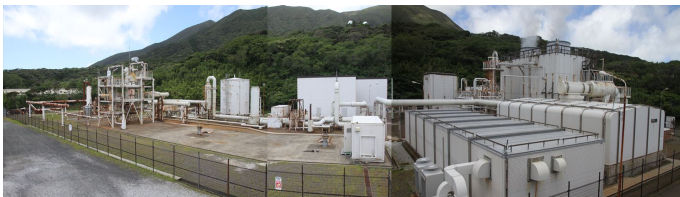
■写真3 八丈島地熱発電所
